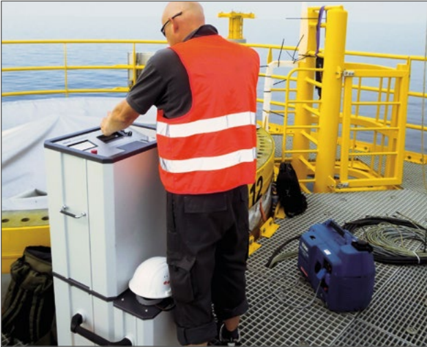
VLF CR de 60 kV en servicio en el parque eólico Baltic 1 (mar Báltico).
