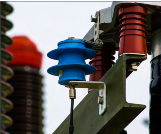
Sensor UHF permanentemente instalado
